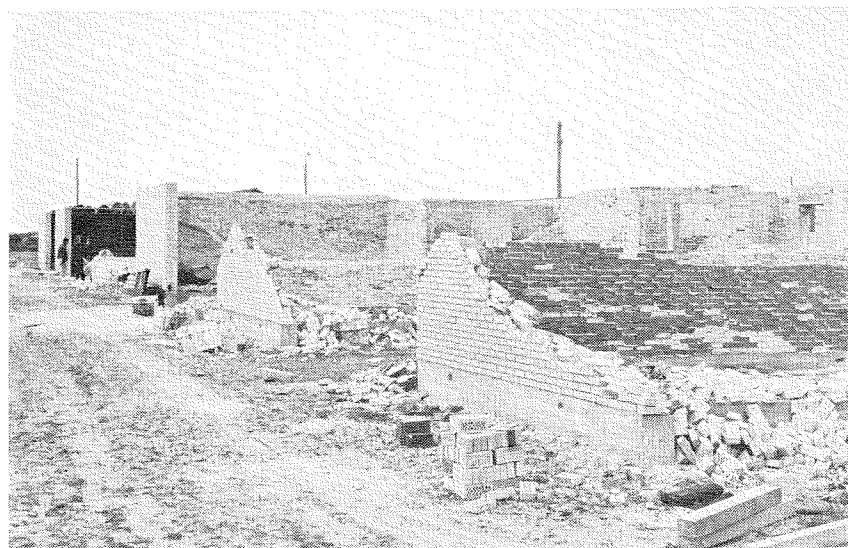
Fig. 7. Frisk opmuret, uafstivet murværk væltet af stormen.
